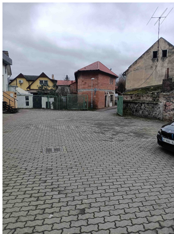
Vpust – odvodnění zpevněné plochy podél opěrné zdi
